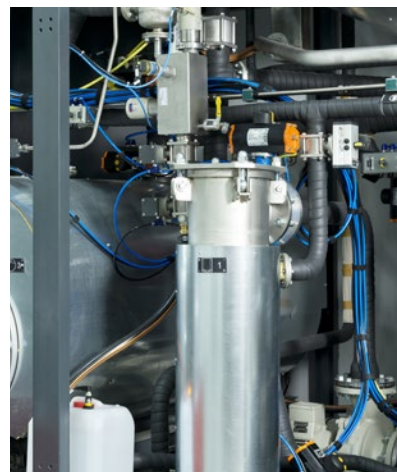
Contrôle et séchage des filtres
